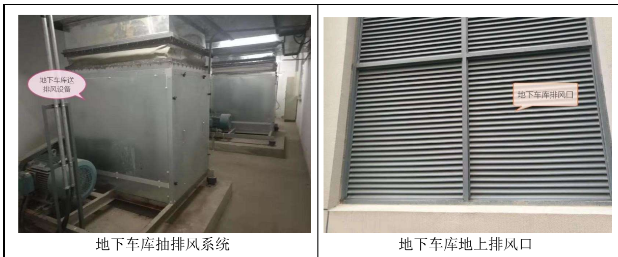
图 5.1-1 本项目废气净化设施
